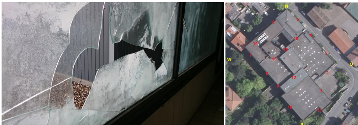
Foto 11.: (links): Gebäude-Abschnitt (12): Eine eingeschlagene Fensterscheibe bietet u.a. Fledermäusen potenziell einen Einflug in das Gebäude. Rechts: Luftbild.
