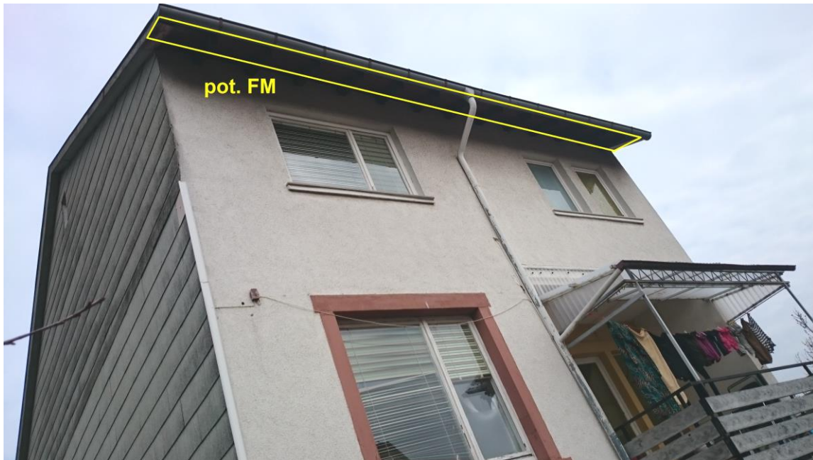
Foto 6.: Südostfassade von A2 (Haus Nr. 13): Der Dachüberstand (gelb markiert) ist vertäfelt und bietet potenziell Spaltenfledermäusen Quartiermöglichkeiten (v.a. Sommer-, aber auch Zwischen- und u.U. Winterquartiere). Daher ist das gesamte Pfannendach manuell und nur außerhalb der Wochenstuben- und Winterquartierzeiten – vorzugsweise im Oktober - im Beisein einer Ökologischen Baubegleitung (ÖBB) abzudecken (s. Kap. 3.1. ).
