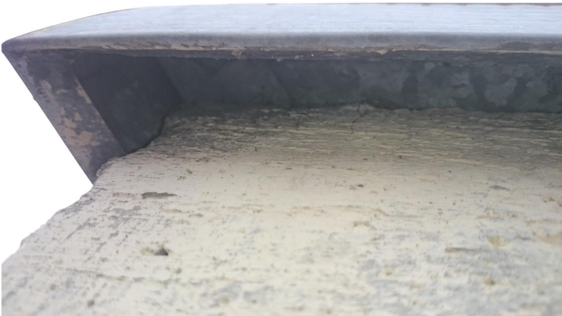
Foto 2.: Die umlaufende Blechverkleidung des Flachdaches der Doppelgarage A1 weist nur Spalten auf, die für Fledermäuse aufgrund ihrer Breite und geringen Tiefe ungeeignet sind.
