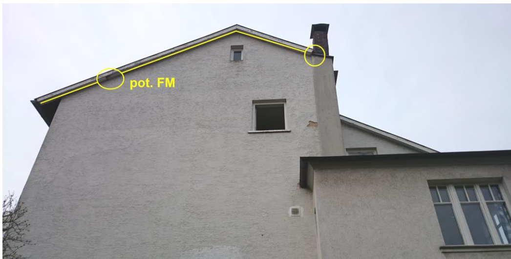
Foto 7.: Nordostfassade von A2 (Haus Nr. 13): Im Bereich des Ortgangs befinden sich Spalten, die Einflüge von Spaltenfledermäusen erlauben. Es sind daher Quartiermöglichkeiten vorhanden (v.a. Sommer-, aber auch Zwischen- und u.U. Winterquartiere). Daher sind die Ortgangbretter manuell und nur außerhalb der Wochenstuben- und Winterquartierzeiten – vorzugsweise im Oktober - im Beisein einer Ökologischen Baubegleitung (ÖBB) zu demontieren (s. Kap. 3.1. ).
