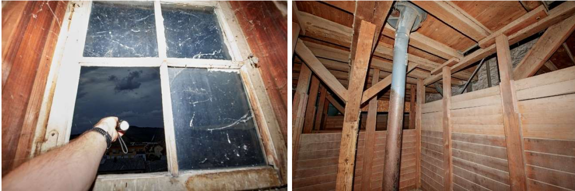
Links: Fenster i. R. Tankstelle ohne Glas, dient als potenzieller Einflug ins Gebäude; rechts: Detailaufnahme des Dachstuhl des Silos im Dachbereich des Sandsteingebäudes (Uwe Scheurich, 15.08.22)
